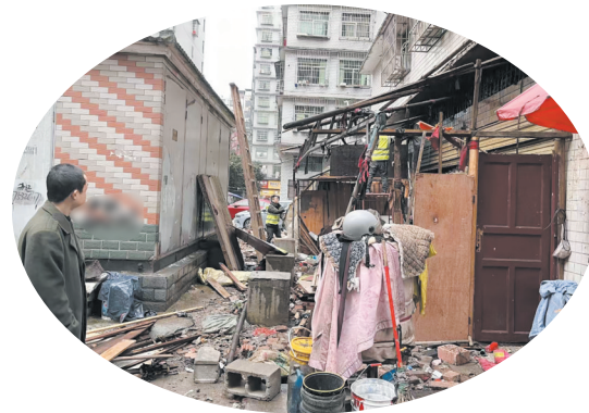
合泰鑫城小区变电房周边治理前垃圾成堆。 受访者/供图
