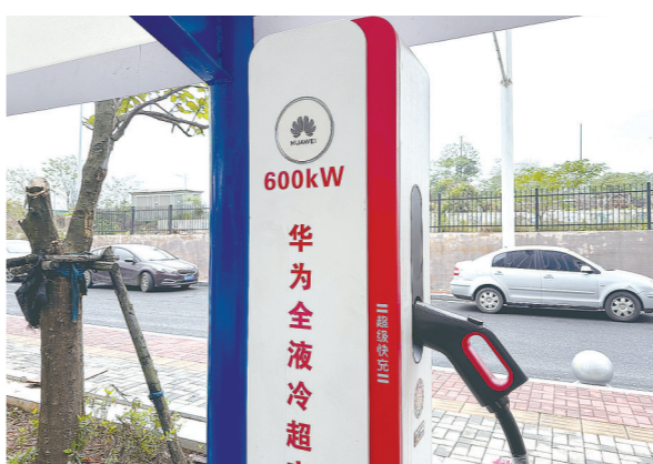
充电站内支持最高600kW的快速充电。记者/张威 摄
