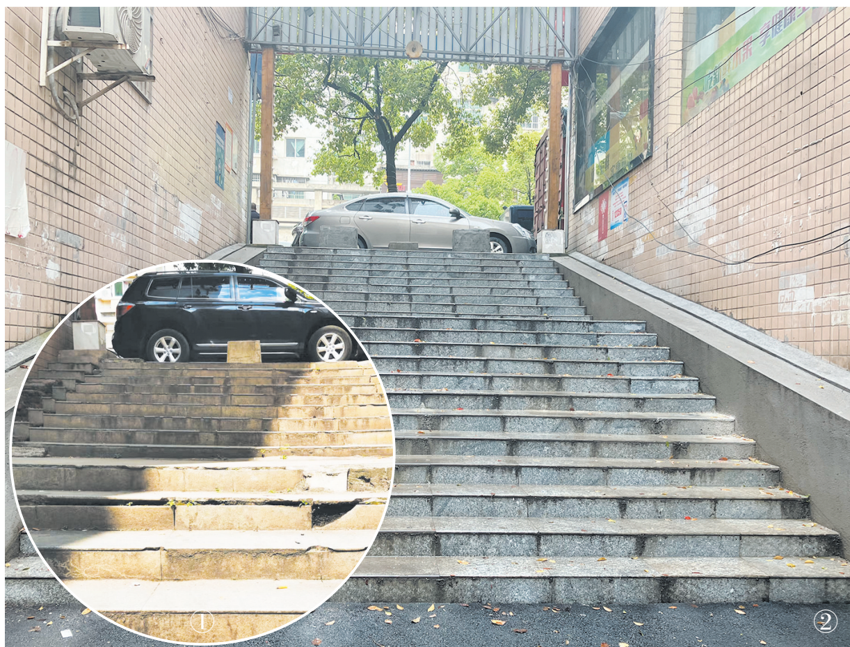
①改造前的碾压新区台阶,不仅破损,且多处下沉。社区供图
