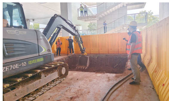
站外垂直电梯施工现场,基坑已开挖至半米深。 记者廖明/摄
