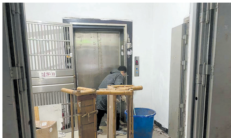
消防隐患整改现场。通讯员 供图
