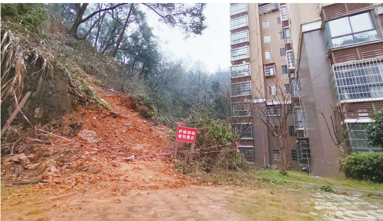
事发多年后,云溪谷小区6栋附近山体滑坡痕迹犹存。记者/易楚曦 摄
