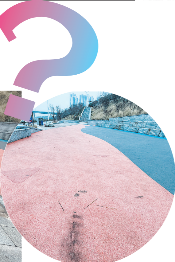
▲湘江风光带河西段,部分路面被烟花爆竹“灼伤”
