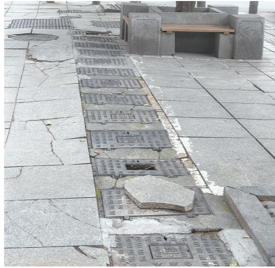
建设中路上，仍有一些“问题井盖”待修复。 记者/伍靖雯 摄
