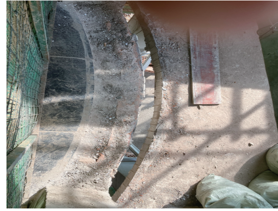
湘银·世纪花园4栋1单元,电梯井道连廊与房屋之间拉开距离达十几公分。
