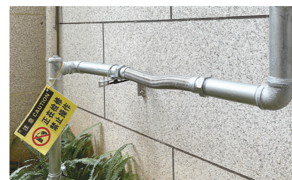
小区燃气管上悬挂检修提示牌。 记者/刘平 摄
