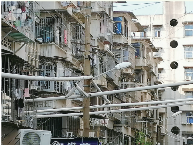
如今的何家坳社区桥头片区,通信线缆已全部被管子套住。 记者/姚时美 摄
