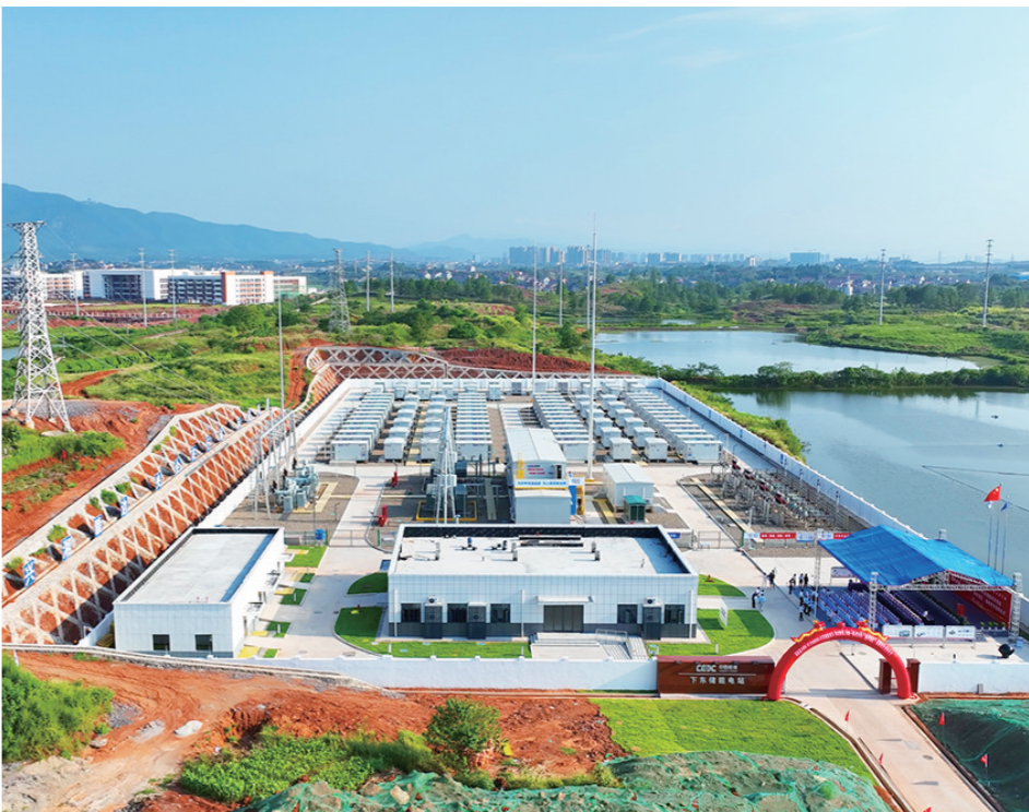
航拍共享储能电站。企业供图
