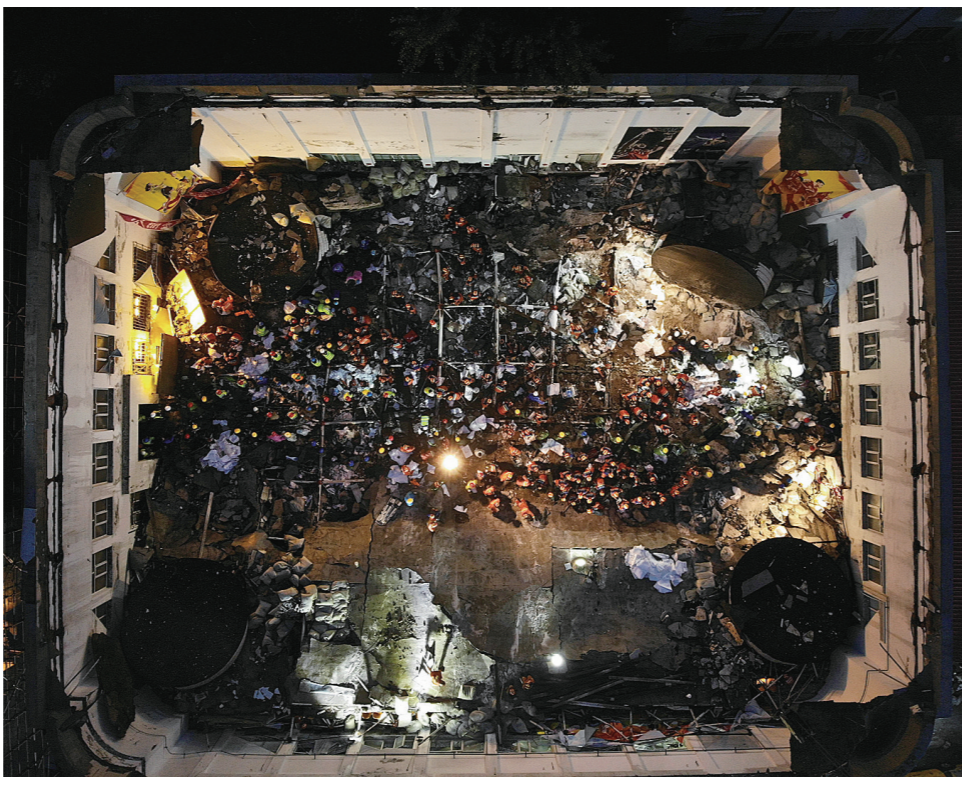
这是7月24日拍摄的齐齐哈尔市第34中学体育馆屋顶坍塌事故救援现场(无人机照片)。新华社记者 王松 摄
