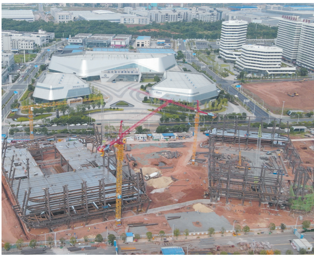
轨道交通装备产业园基础设施项目一期施工现场。记者/周嵩 摄
