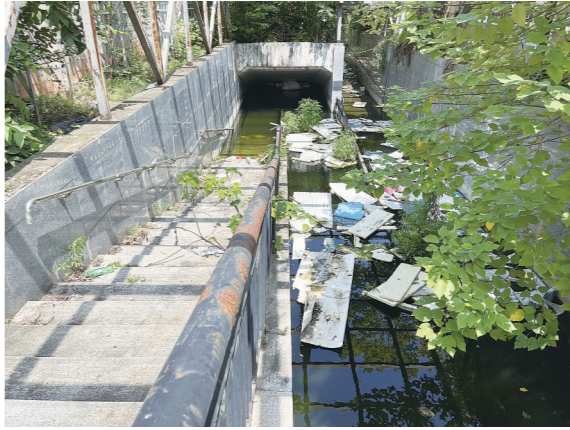
地下通道内积水严重,漂浮不少垃圾。 记者/刘平 摄
