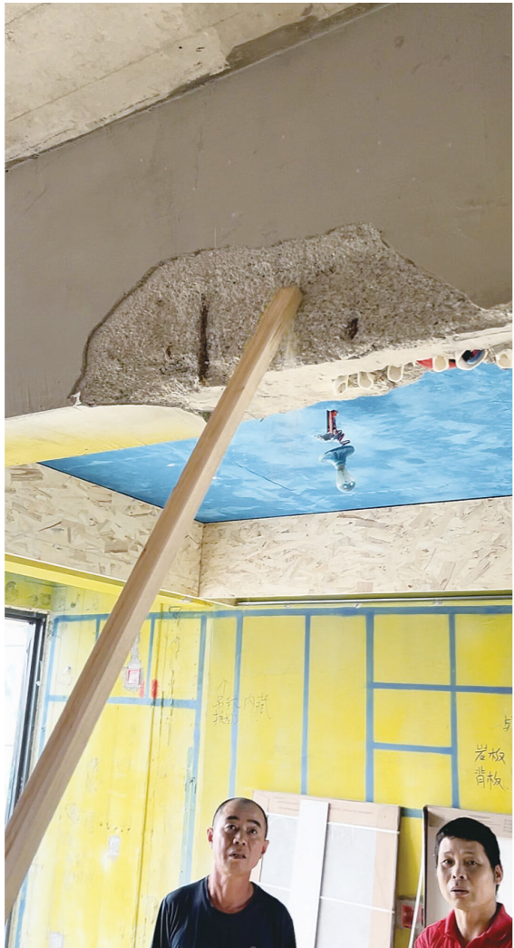
用木棍戳房梁，有碎渣状物质掉落。 记者/刘平 摄
