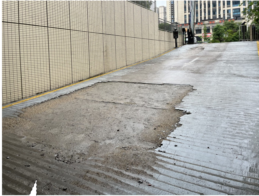
5月10日，碧海家园小区地下车库，破损地面依然未修复。 记者/刘平 摄
