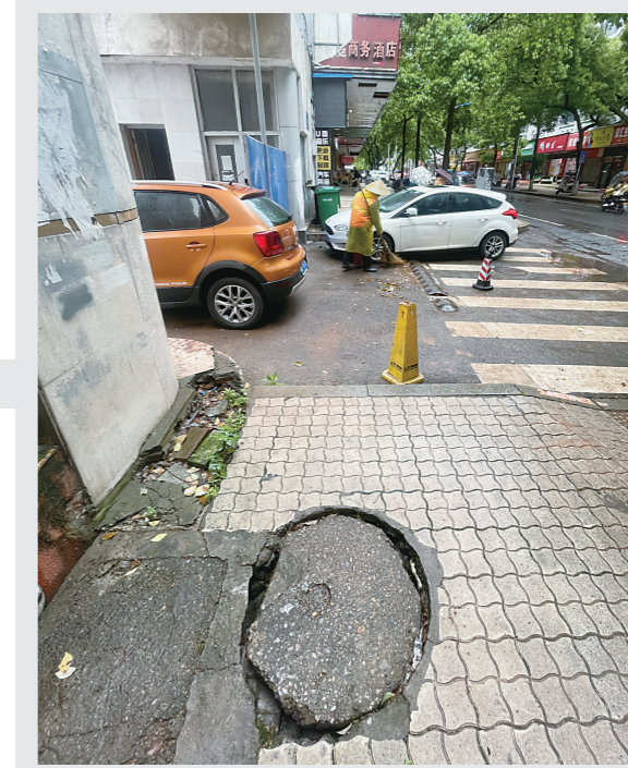
▲公园路上一处破损的窨井盖,踩上去咣当作响。 记者/伍靖雯 摄
