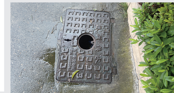
▲建设中路,一处窨井盖出现缺损。 记者/伍靖雯 摄
