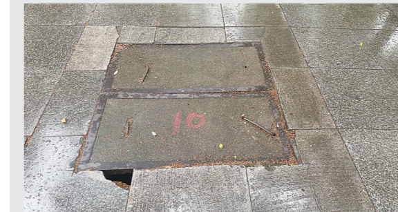
▲建设中路上的一处窨井盖,井周破损出现空洞。 记者/伍靖雯 摄
