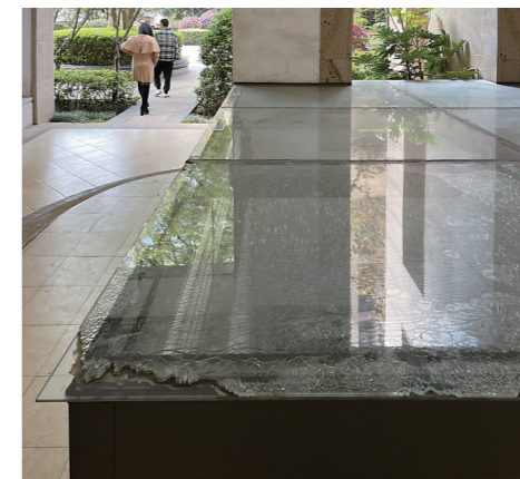
封住地下车库天井的玻璃破损。 记者/刘平 摄
