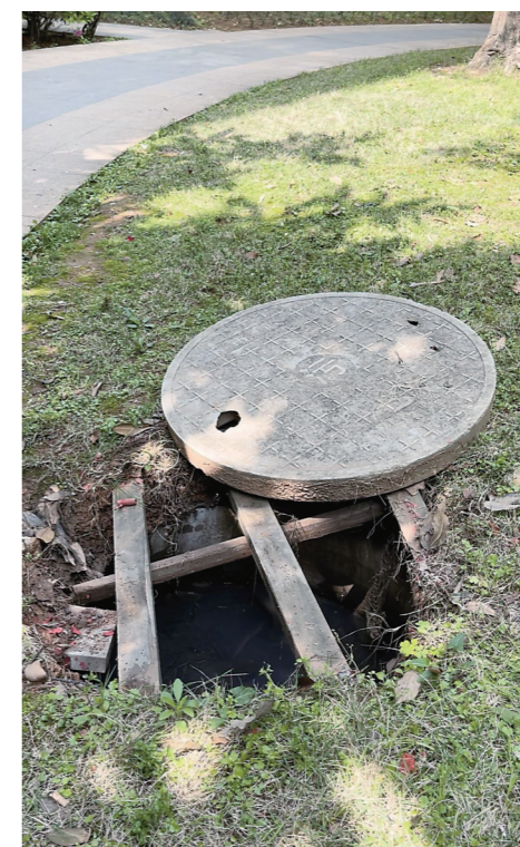
小区污水井盖子打开,存在安全隐患。 记者/刘平 摄
