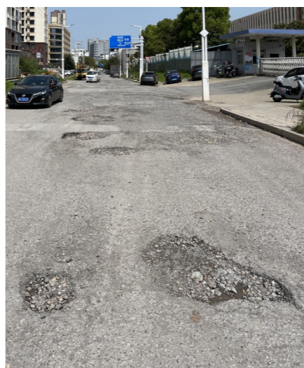
▲服饰二路路面破损,多处有坑洞。记者/刘平 摄
