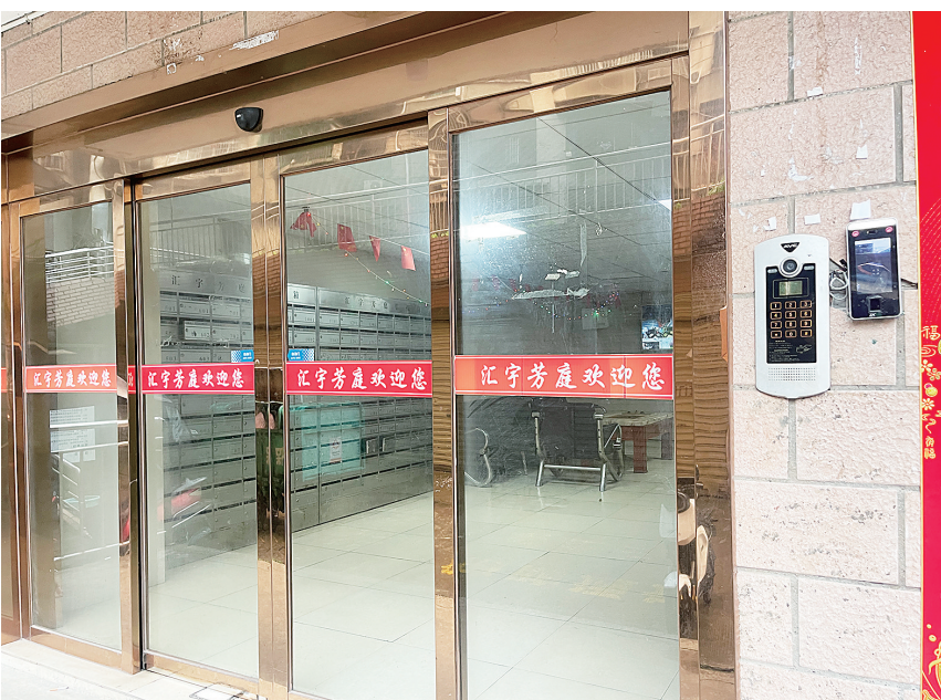
小区内安装了带人脸识别系统的电动门。记者伍靖雯摄
