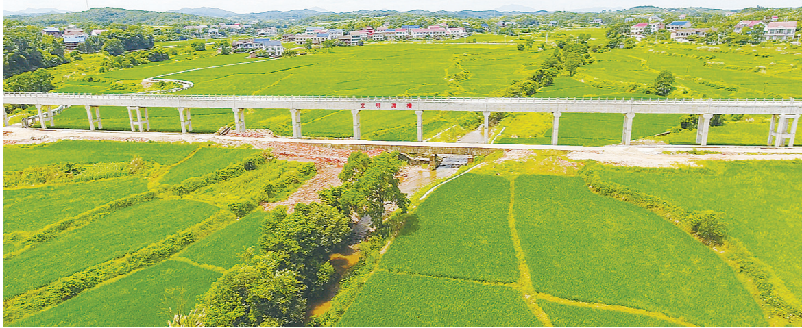
酒埠江灌区改造项目之新建的文明渡槽。记者/俞强年 通讯员/谭琦 摄
