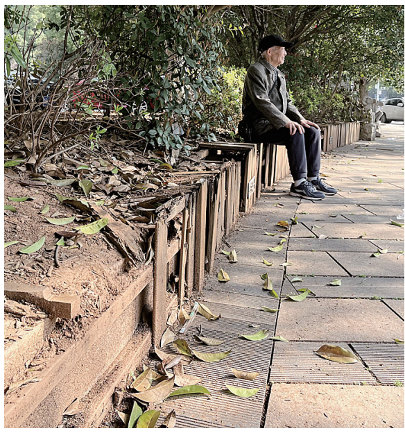
广场上,坐凳破损。记者/刘平 摄
