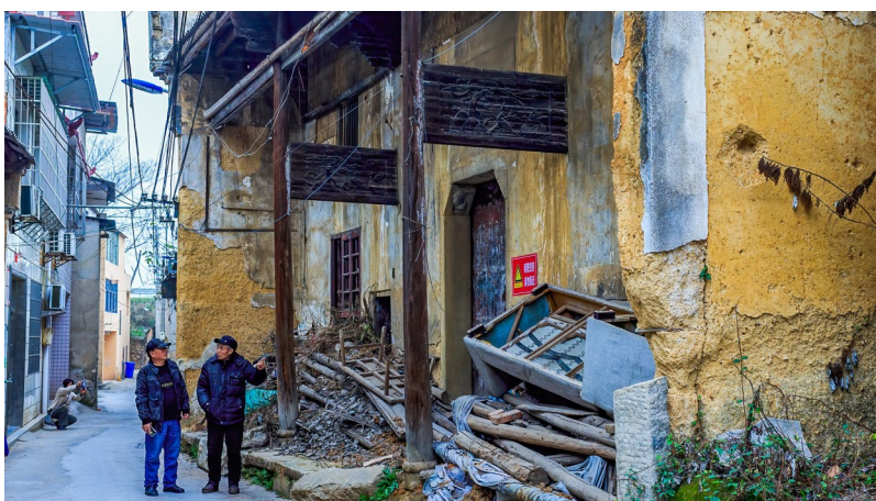
老街上缺乏修缮的建筑。陈向东 摄
