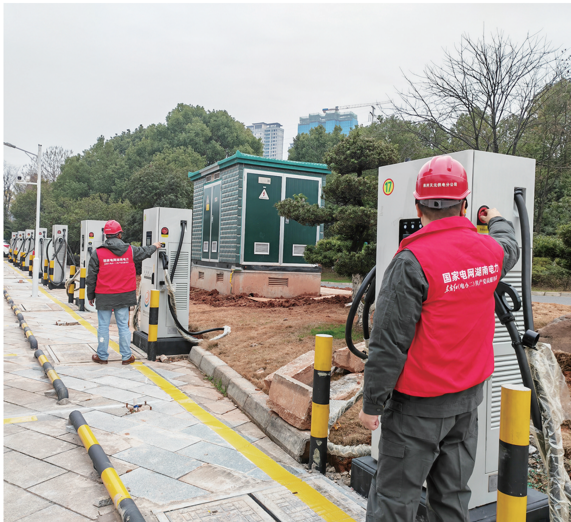
▲充电站顺利完成充电桩电源送电。 企业供图
