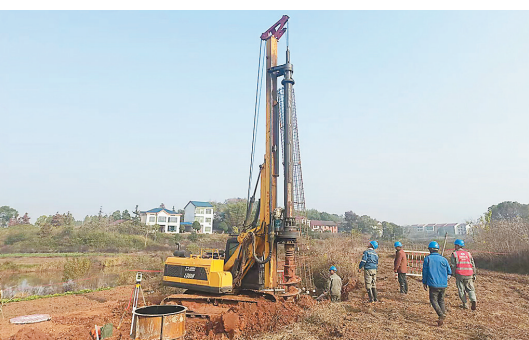
攸县电力线路工程项目建设现场。 记者/刘芳 通讯员/邓凌毅 摄
