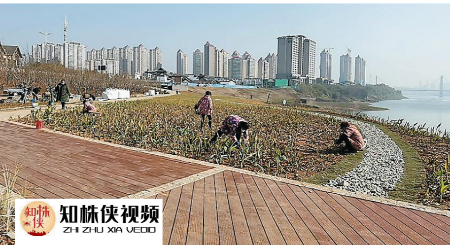
12月13日,河西湘江风光带延伸段(凯悦大酒店至建宁大桥段)工程进入收尾阶段。项目现场,游园、绿植及游步道等已具雏形,施工工人抢抓好天气施工。预计本月底向市民开放。 株洲日报全媒体记者/李军 摄
