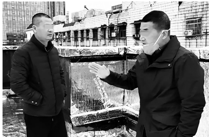
▲业主包先生(左)向技术人员询问漏水原因。记者/易楚瞳 摄
