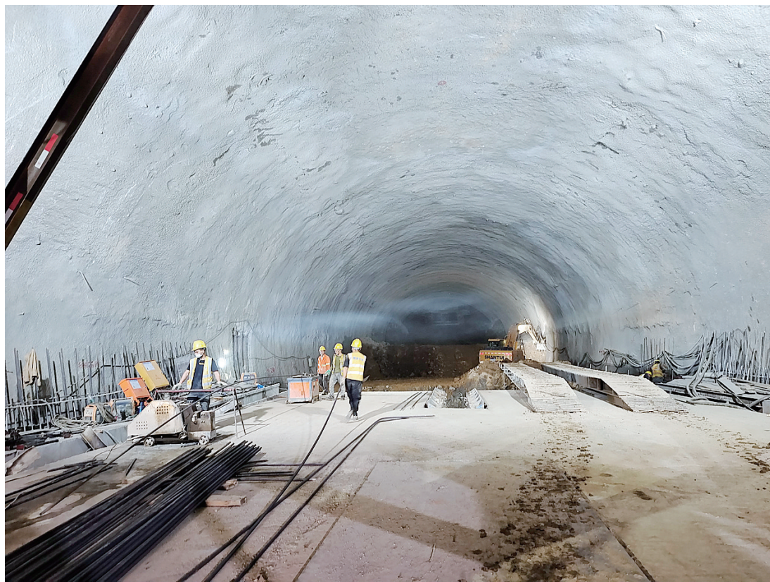
醴娄高速排山冲隧道施工现场。株洲日报全媒体记者/廖明 摄
