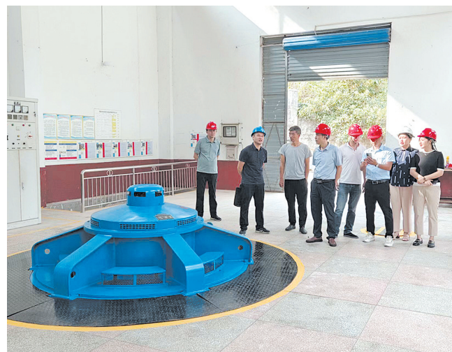
炎陵县小水电站数字化监管改造项目现场。通讯员 供图
