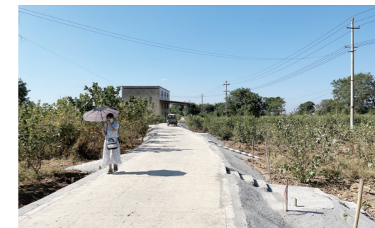
▲拓宽后的道路。记者/刘平 摄
