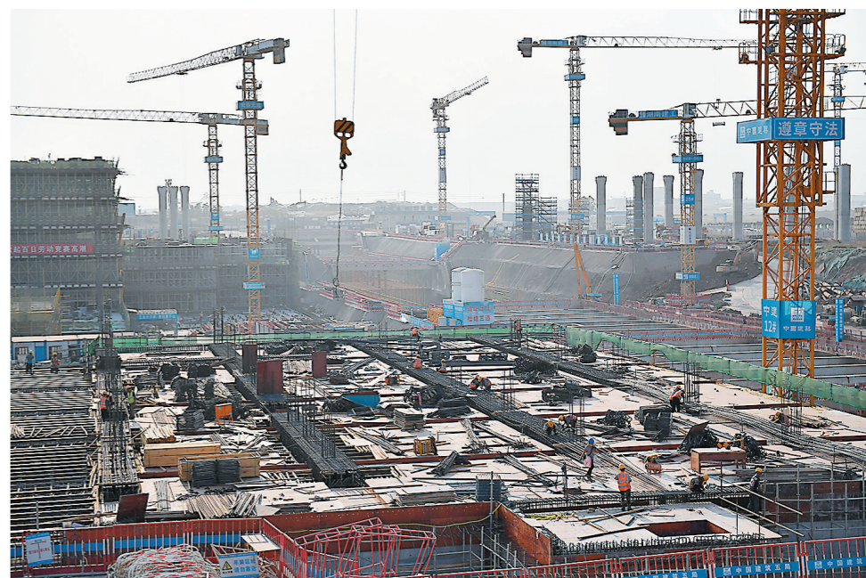
9月12日，中建五局的施工人员在长沙机场改扩建工程综合交通枢纽工程项目现场作业。中秋假期期间，在长沙机场改扩建工程综合
