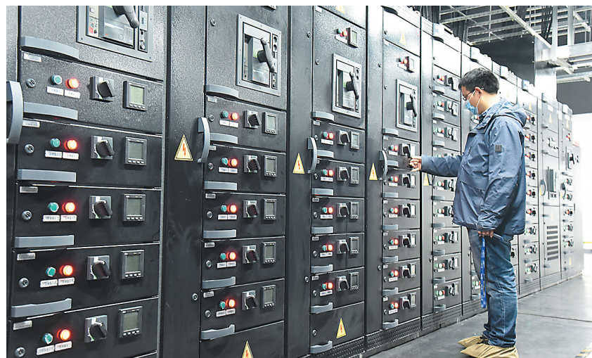
湖南华云数据湖信息技术有限公司数据机房。
