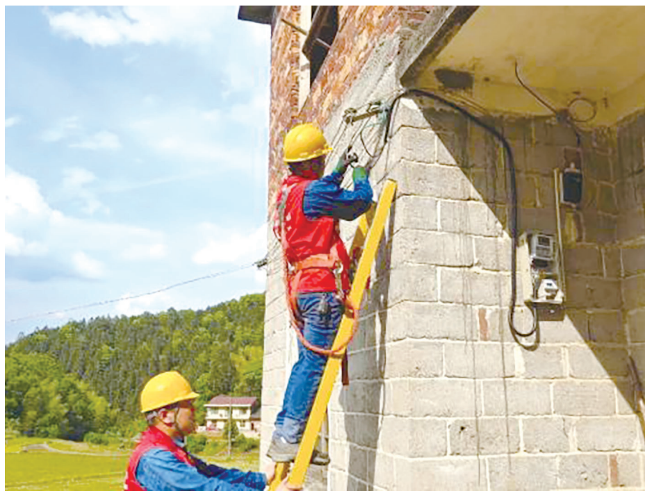
“村电共治”实施后，村民可享受供电工作人员快捷高效的上门服务。
