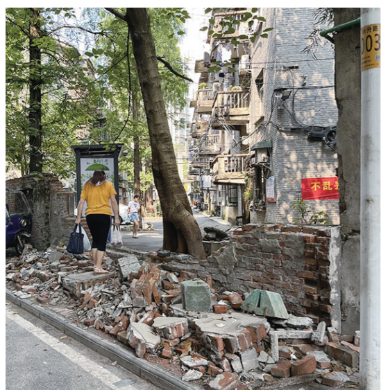
围墙倒塌后遗留的砖头碎块等堆在人行道上,影响居民通行。 记者/刘平 摄
