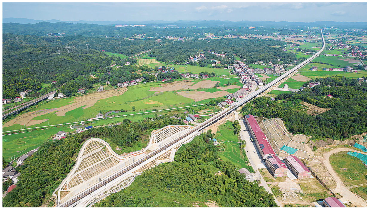
这是7月23日在湖南省益阳市桃江县拍摄的常益长铁路(无人拍照)。当日,在常德(益)阳(长)铁路常益段铺轨现场,随着中铁十一局
