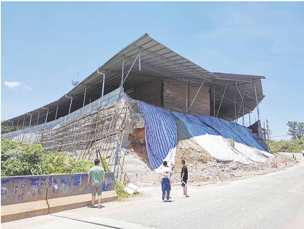
▲潘家冲萤石矿中转场发生垮塌的护坡。记者/姚时美 摄
