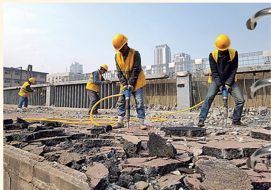
2020年12月24日,新华桥桥面破拆(资料图)。 株洲日报全媒体记者/谭浩瀚 摄
