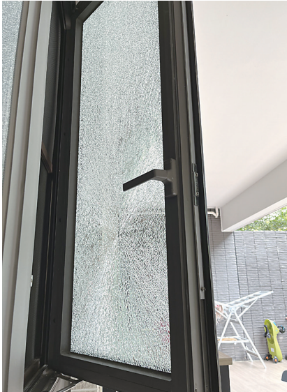
▲24日上午,湘水湾小区一住户家的窗户玻璃爆裂。记者/刘平 摄
