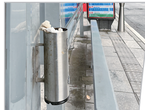
▲公交车站候车棚的小型垃圾桶破损,还有污迹。 记者/刘平 摄
