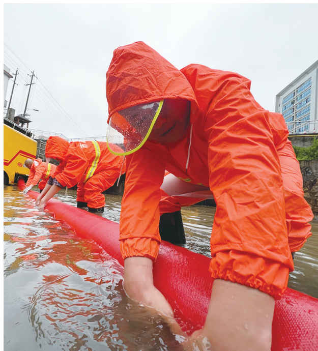
红旗南路跨石宋路桥下积水影响交通,市市政工程维护中心派出“龙吸水”设备紧急排涝。
