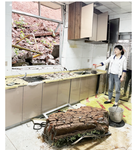
▲护坡垮塌,彭女士家厨房受损。记者/刘平 摄
