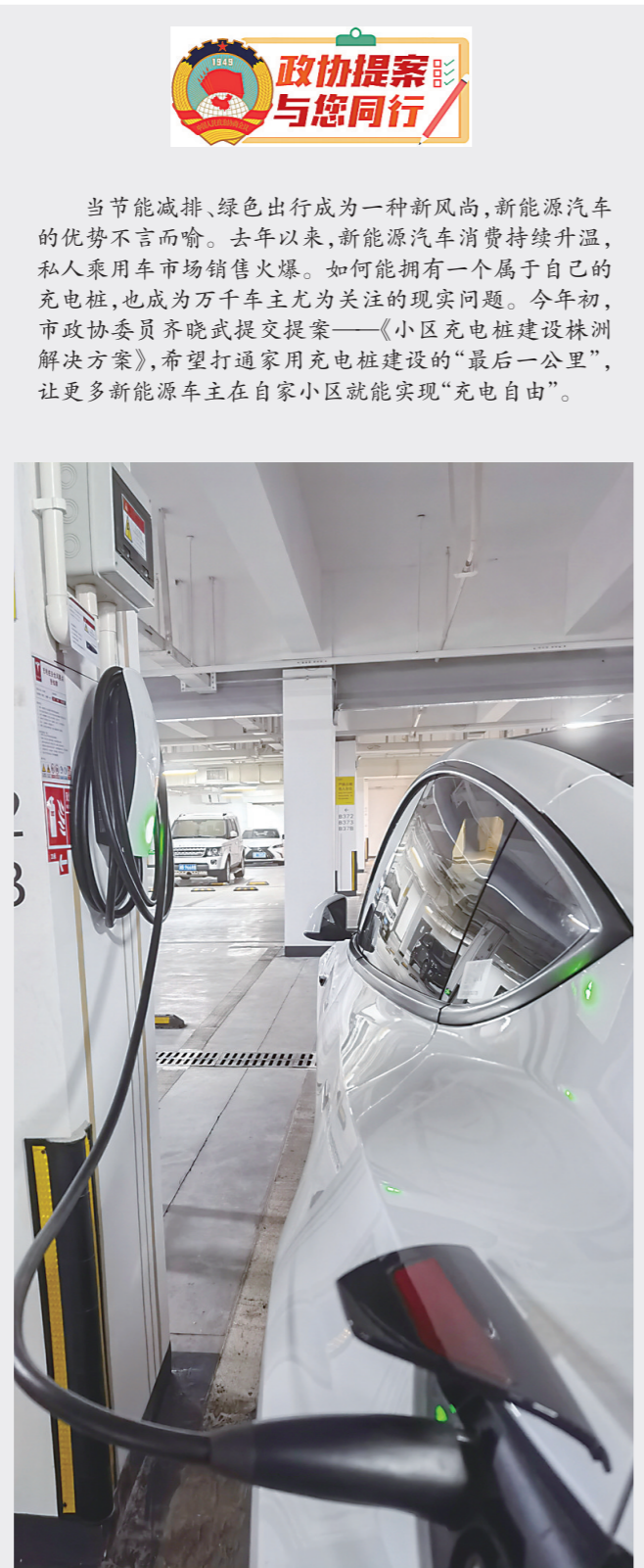
▲经过近4个月的努力,近日,晋合·湘水湾小区业主终于在自家车位安装了充电桩。受访者供图
