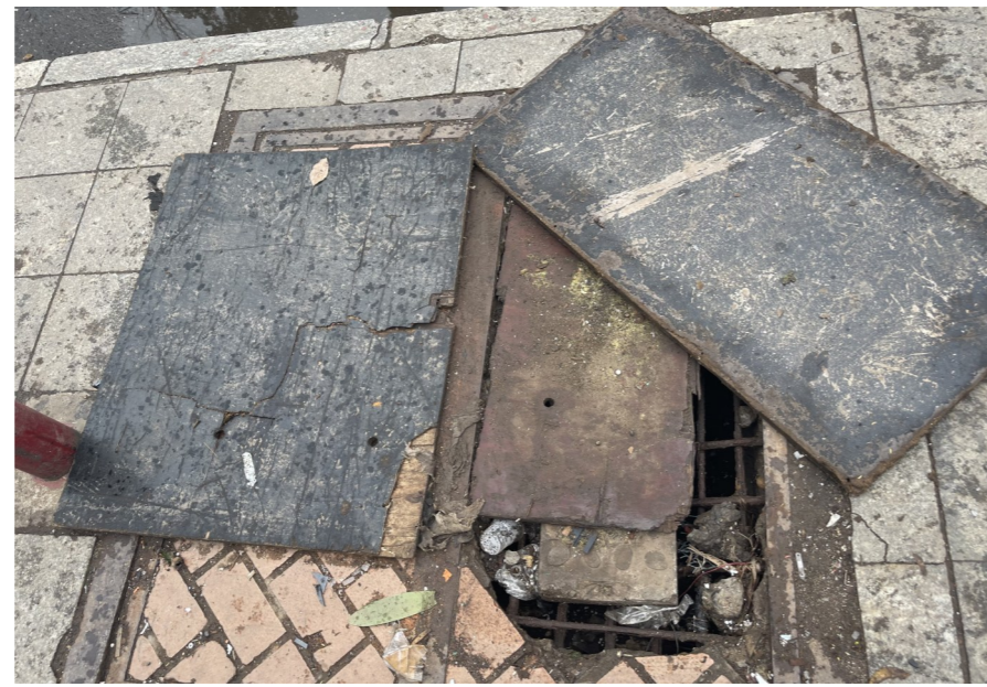
▲沿江北路人行道上的破损的窞井盖。 记者/伍靖雯 摄
