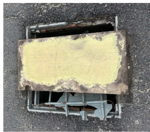
▲公园路附近一处破损窞井盖,被人用木板简单遮蔽。 记者/伍靖雯 摄
