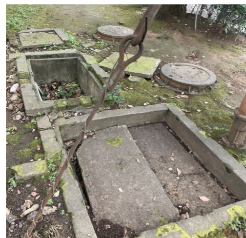
▲纺织路附近,两处下沉式窞井让居民忧心。 记者/伍靖雯 摄
