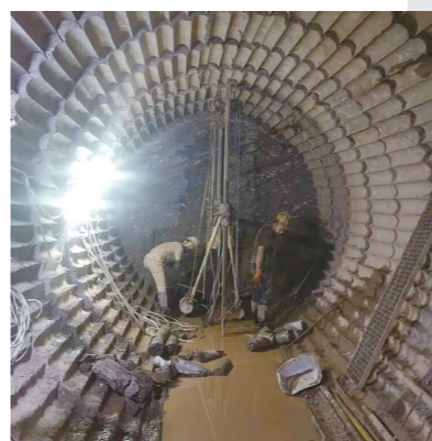
施工方对中风化砾岩采用水磨钻成孔方法进行施工。 株洲日报·掌上株洲 通讯员/倪得利 供图
