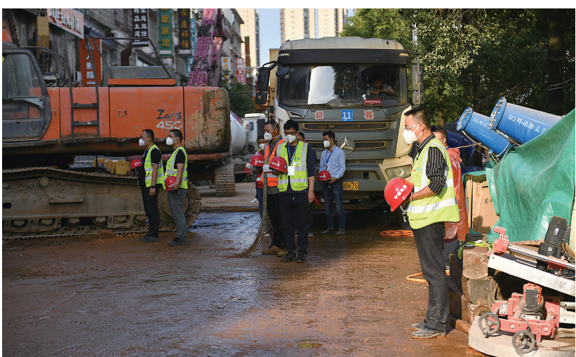
5月4日,长沙居民自建房倒塌事故现场,搜救人员向遇难者致哀,愿逝者安息。新华社发
