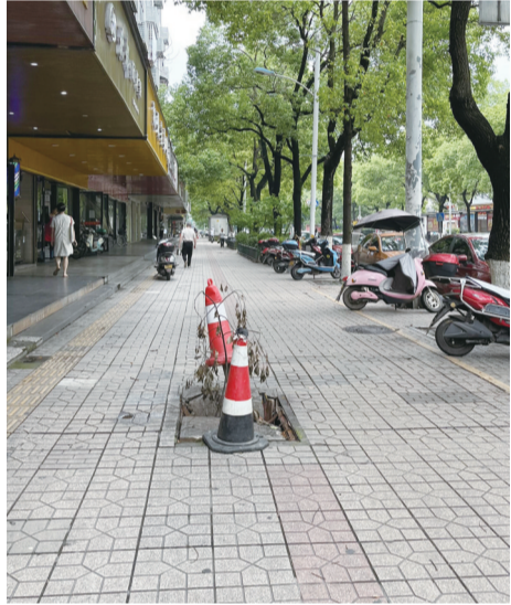
4月26日,在建设北路人行道上,破损井盖仍未更换。株洲日报·掌上株洲记者/刘平 摄
