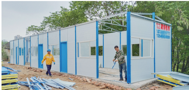
刚刚建好的板房被责令拆除。株洲日报·掌上株洲记者/刘平 摄
