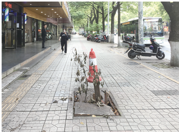
井盖破损处插上了树枝。记者刘平摄
