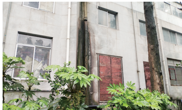
▲建宁街道办事处一根污水管道断裂。记者/廖智勇 摄
