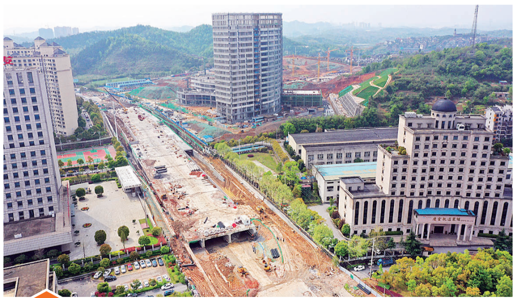
枫溪大道(608所段)下穿改造工程的主体工程目前已经完成,正在进行附属工程施工,预计2022年6月底全部完成。图为近日航拍画面。
